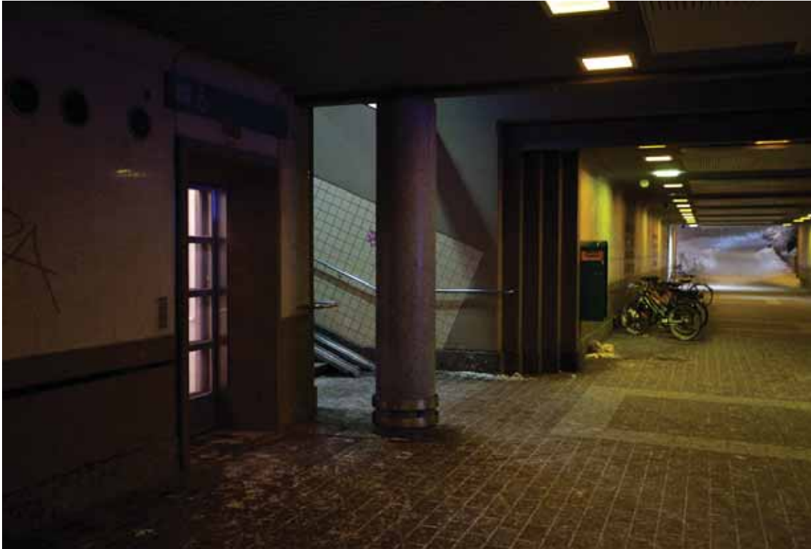
Kuva 6.4-8 Ilman korostusvalaistusta hissien sisäänkäynti on hankalasti havaittavissa.
