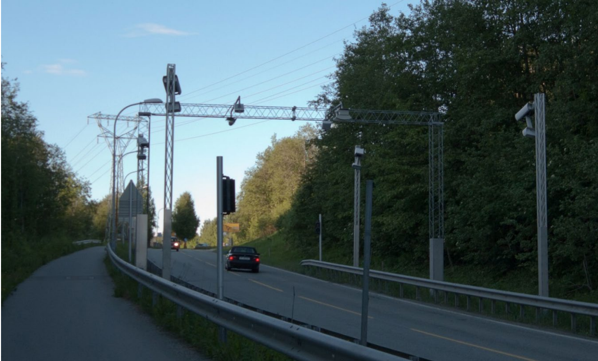
Kuva 13. Tiemaksujen valvontaan käytettävä tienvarsilaitteisto (RSE) Trondheimissa. Laitteisto sisältää sekä DSRC- että ANPR-järjestelmien laitteiston (Fjellby 2013).
